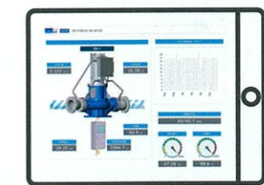
遠隔監視時 (タブレット)
